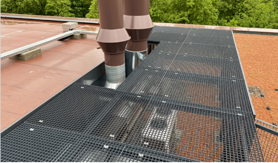
Sicht von oben: Ausschnitte für die Lüftungsrohre. Die Frontelemente führen bis oberkant Dachelemente.
